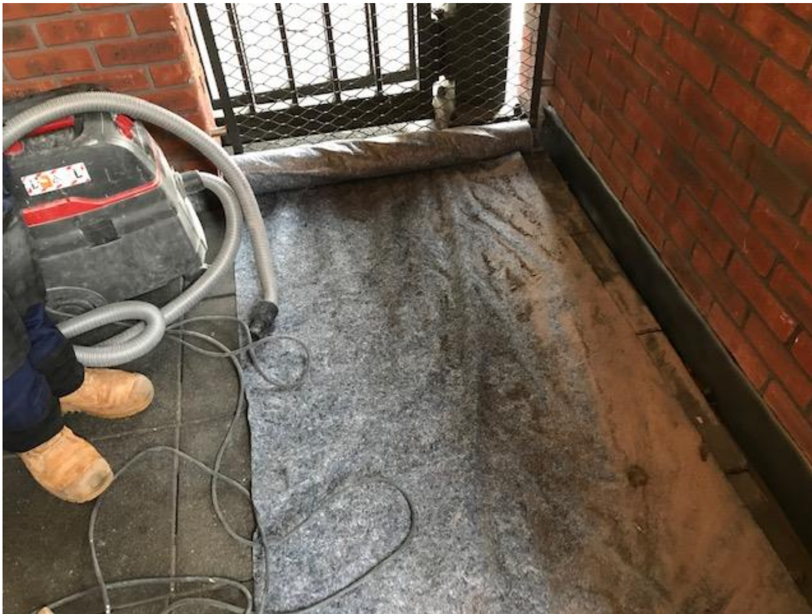
18 april - Gestolen lood wordt vervangen door neplood. Hier een proefstuk
